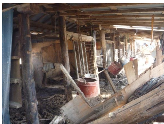
(写真2) 馬房の地震による被害
